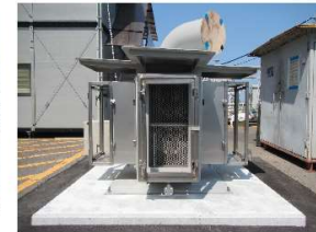
フィルタコンテナユニット (1基/可搬型DGポンプ)
