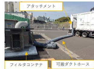
フィルタコンテナ接続状態
