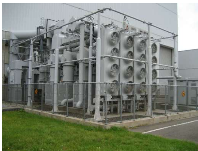
第1図 変圧器外観
