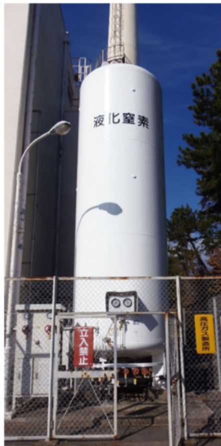
窒素ガス供給設備
