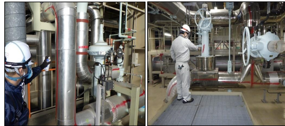
今回解体対象設備となる配管等に赤色のマーキングを施した。
