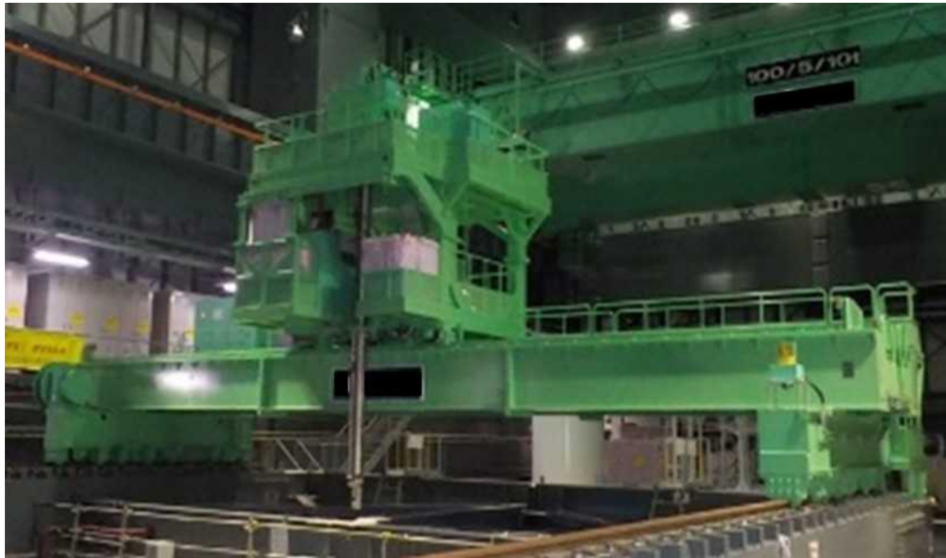
有効活用する4号機燃料取扱機
