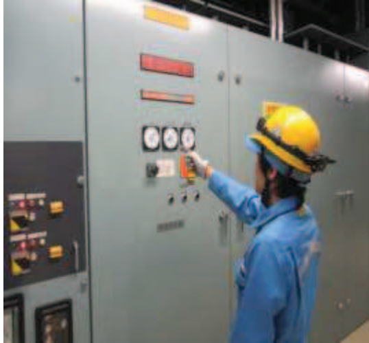
125V 代替充電器の受電状態確認
