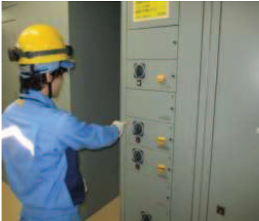
MCC 負荷の切離し操作
