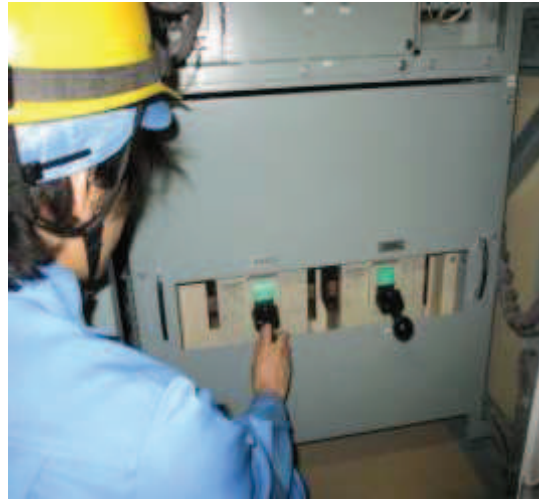
125V 代替蓄電池の切操作
