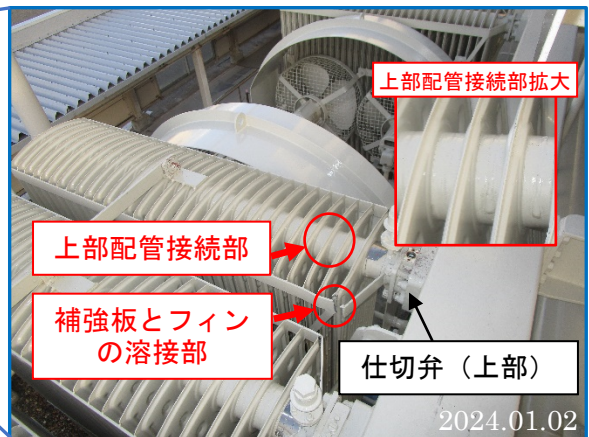
No. 4 放熱器損傷箇所
