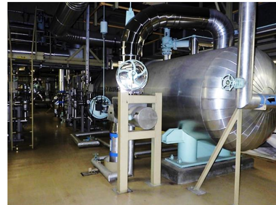
高圧給水加熱器
