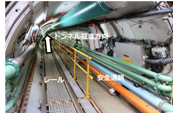
トンネル内部安全設備の整備状況
