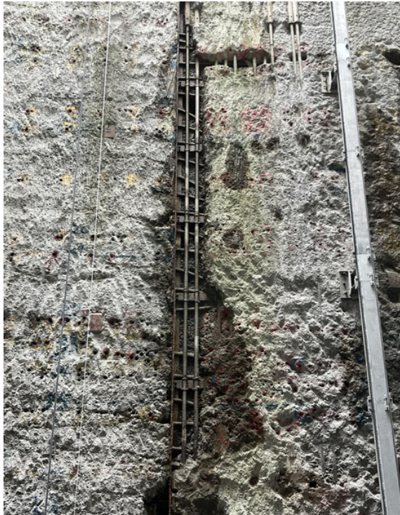
図1 コンクリートの未充填及び鉄筋の変形等の状況写真 (調査のため一部のコンクリートを除去した状態)
