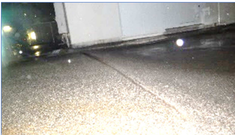
高圧電源車アクセスルートの段差
