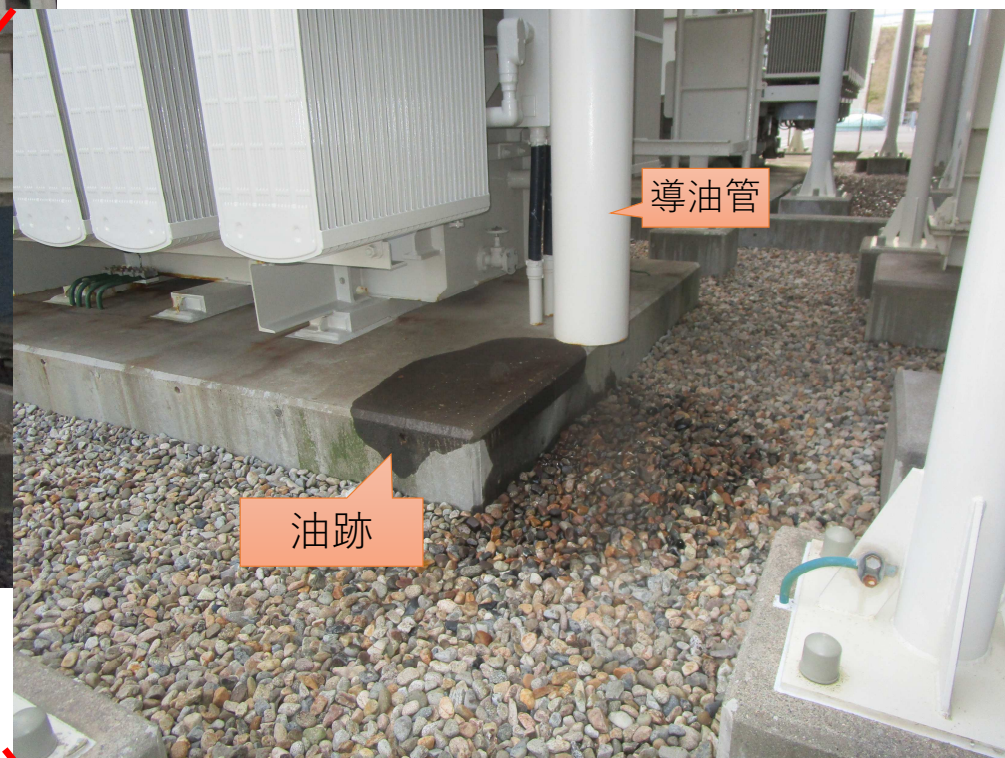
2号機 励磁電源変圧器の油漏れ
