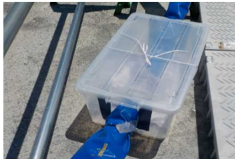
【耐圧ホース接続箇所】
