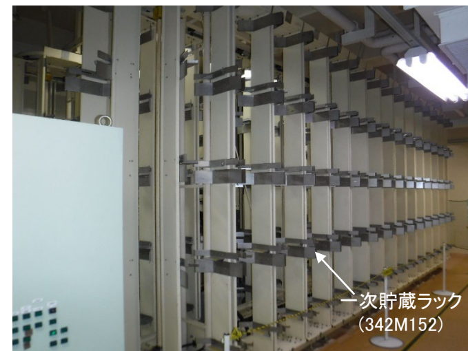
写真① 一時貯蔵ラック(342M152)
