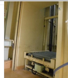
シャッター (乙種防火戸) (保守作業中につき シャッター開状態)
