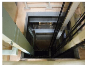
床 (カートン搬出リフトの開口部)
