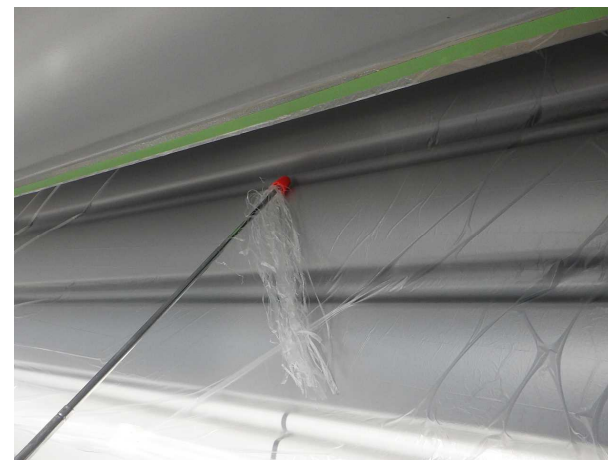
目張り実施中
