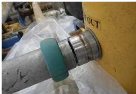
ガスケット（ビクトリックジョイント部）
