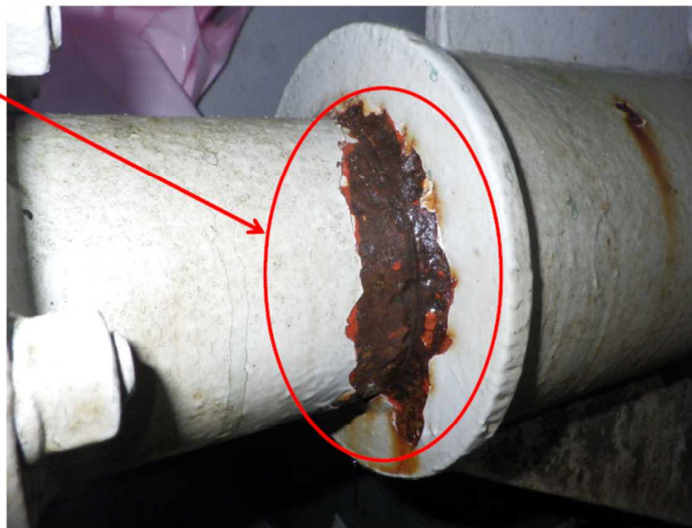
漏えい箇所 塗装剥離状況
