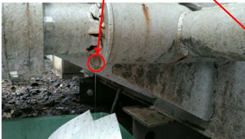
絶縁油漏えい状況
