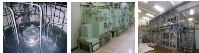
⑤廃液貯槽 ⑥プリスターセル ⑦フード
