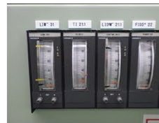
④温度指示計(制御盤)
