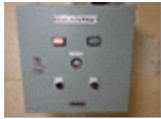
⑤炭酸ガス消火設備(操作盤)
