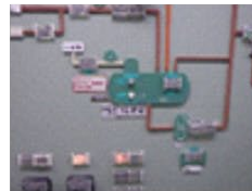
②温度上限警報(制御盤)
