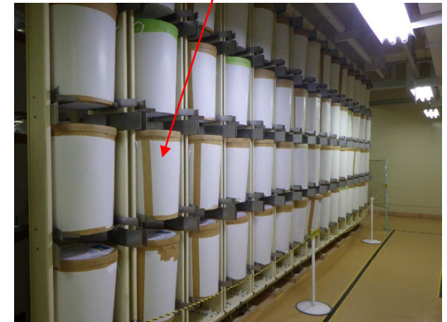
焼却炉運転時の一次貯蔵ラック(342M151/M152)の状況 (運転時は、低放射性固体廃棄物を自動搬送する。)
