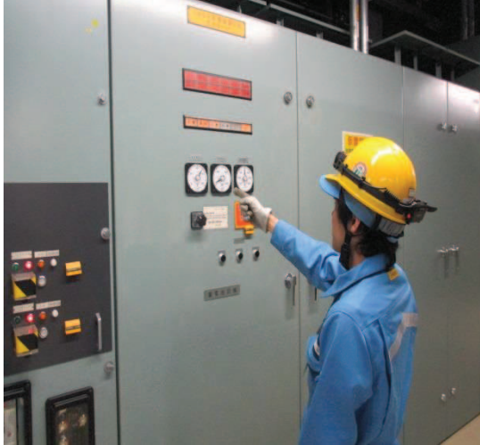
125V 代替充電器の受電状態確認
