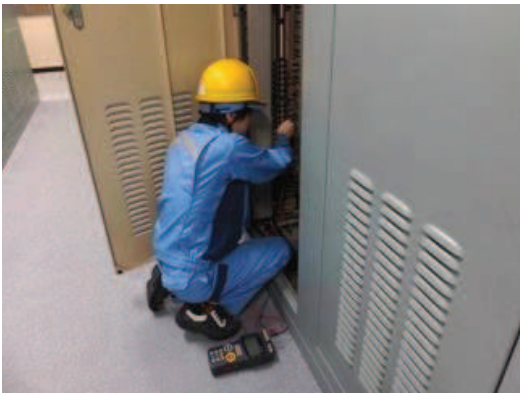
可搬型計測器接続
