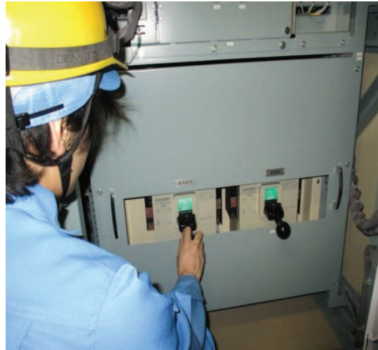
125V 代替蓄電池の切操作
