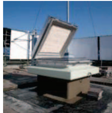
原子炉建屋ベント設備（開放状態）
