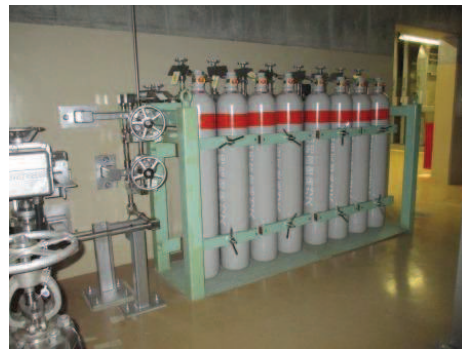
高圧窒素ガスポンペ
