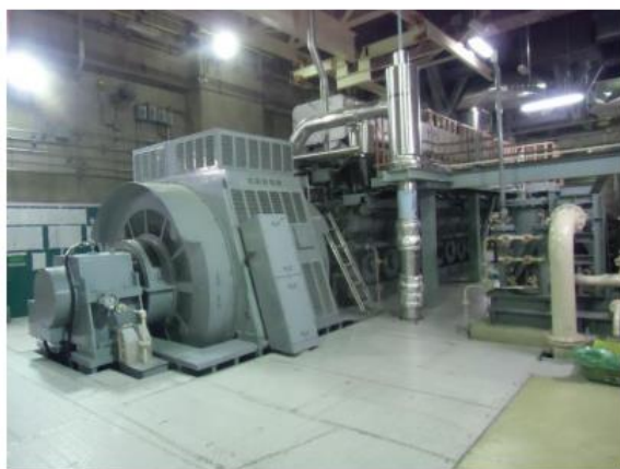
非常用ディーゼル発電機 外観写真
