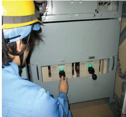
125V 代替蓄電池の切操作
