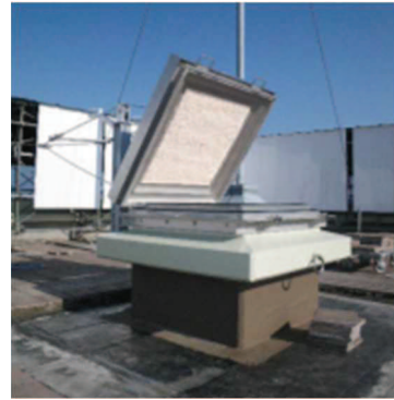
原子炉建屋ベント設備（開放状態）
