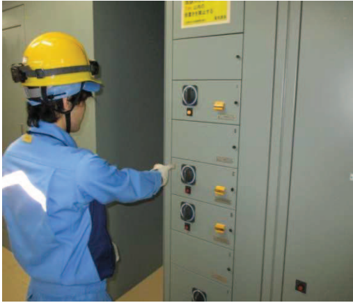
MCC 負荷の切離し操作
