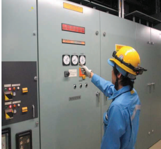
125V 代替充電器の受電状態確認
