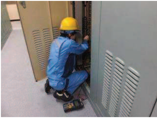
可搬型計測器接続
