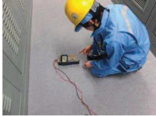
電池容量確認
