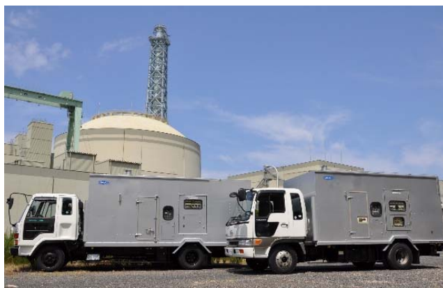
300kVA電源車 2 台
