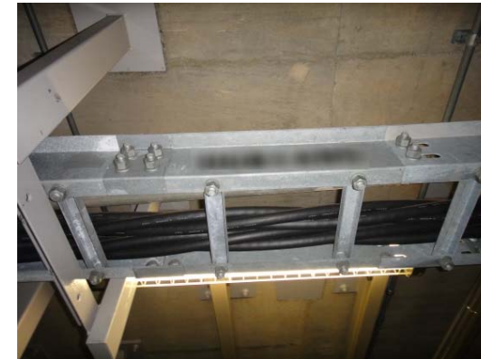
難燃性ケーブルの使用
