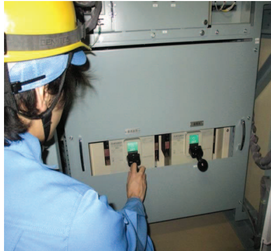
125V 代替蓄電池の切操作
