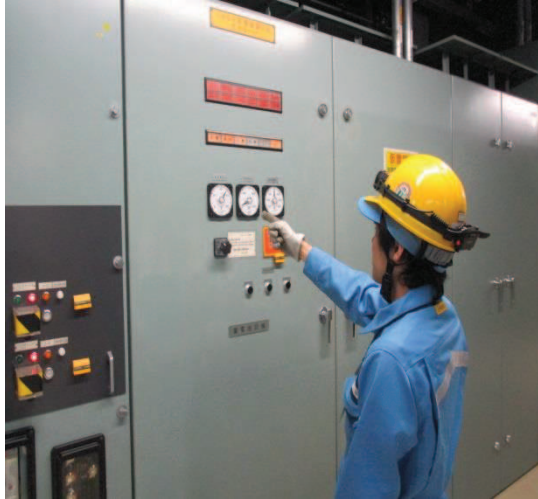
125V 代替充電器の受電状態確認
