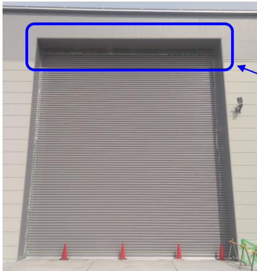
建屋南西 重量シャッター (建屋外より撮影) (幅9.4m×高さ10.8m)
