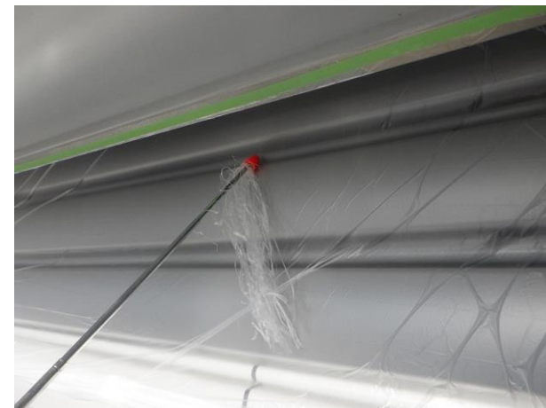
目張り実施中
