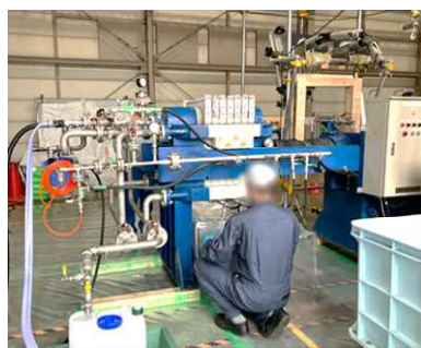
脱水処理(圧搾工程)
