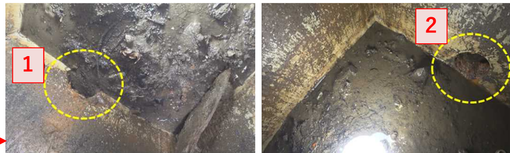
(2) ピット近傍のマンホール内の状況 (黄丸はマンホール内で確認された穴)
