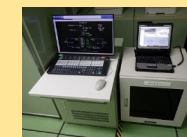
HAWパラメータ監視システム
