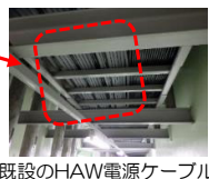
既設のHAW電源ケーブル
