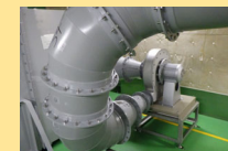
可搬型換気設備
