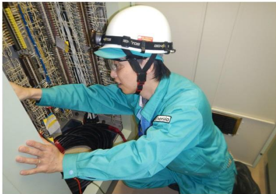
可搬型計測器接続
