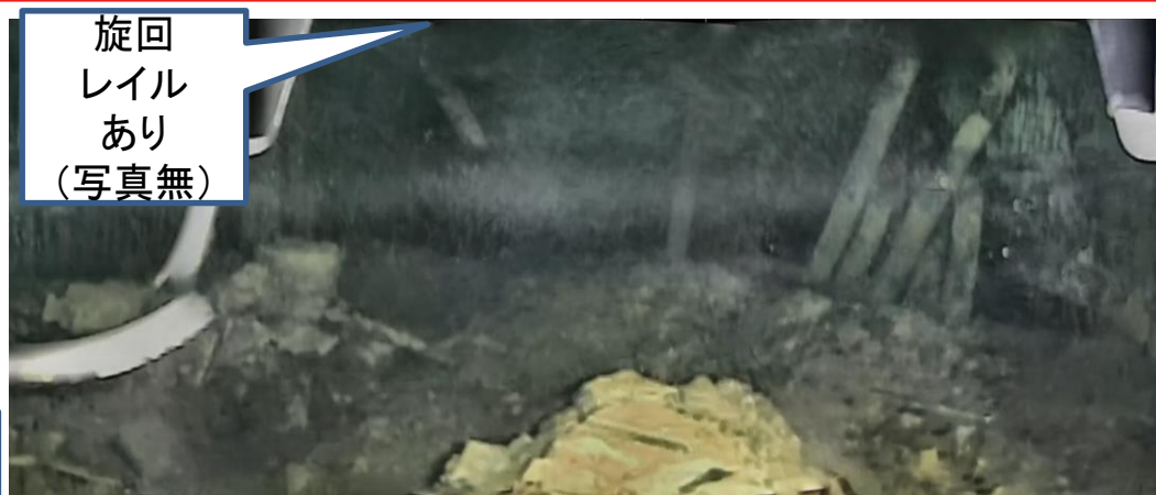
写真1. 1号機のペDESTAL内の状況
