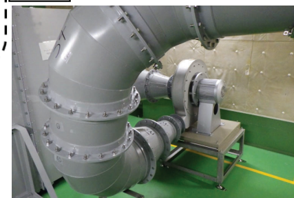
可搬型換気設備の設置時の様子
