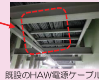
既設のHAW電源ケーブル
