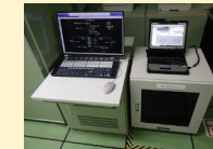
HAWパラメータ監視システム
