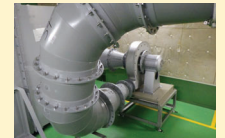
可搬型換気設備
