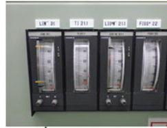
④温度指示計(制御盤)
