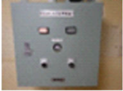
⑤炭酸ガス消火設備(操作盤)
