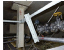
①温度記録上限緊急操作装置(熱電対)
