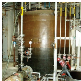
排水処理設備 (廃液槽)
