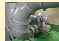
可搬型換気設備
