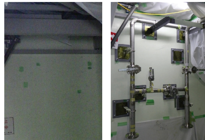
設置前 設置後 冷却水配管への接続口の設置状況 (令和3年12月)
