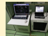
HAWパラメータ監視システム
