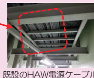
既設のHAW電源ケーブル
