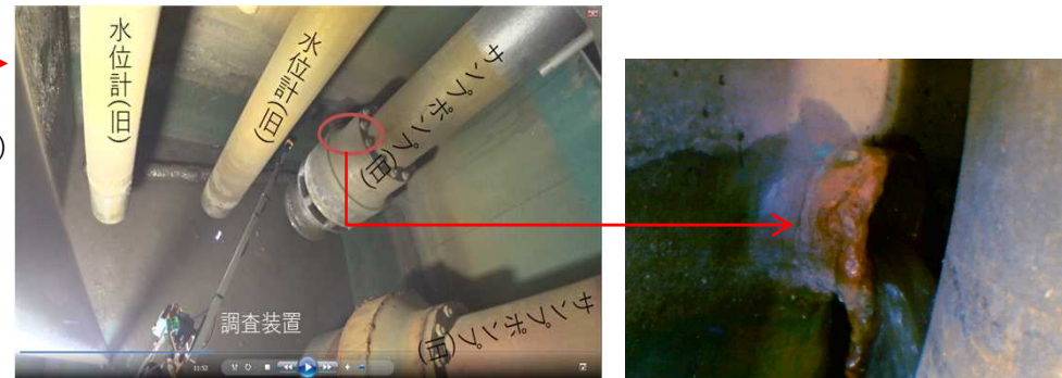
(1) ピット南東側壁に確認された配管からの流入状況
