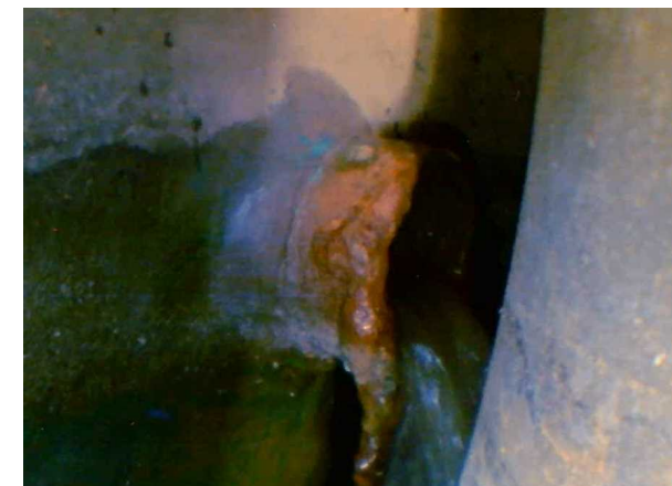
ピット南東側壁に確認された配管からの流入状況（散水中）15
