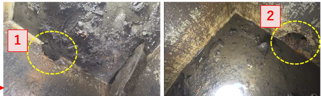
(2) ピット近傍のマンホール内の状況 (黄枠はマンホール内で確認された穴)
