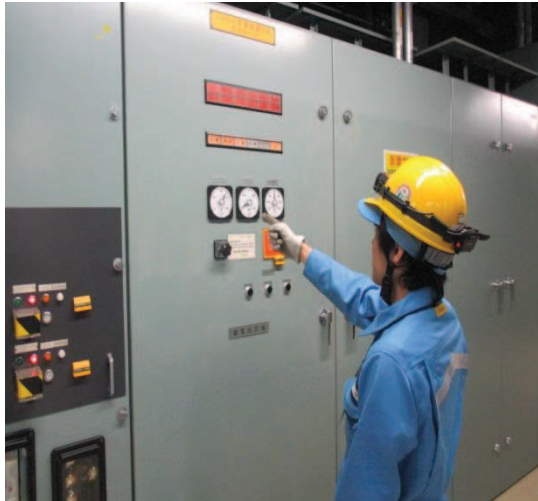
125V 代替充電器の受電状態確認
