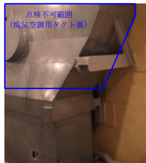
図5. 1 接近可能だが要領書で定めたデータ採取方法の要求条件が確保できない範囲の例 (高浜4号炉の写真)
