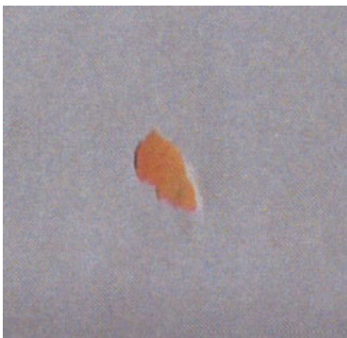
フロー②と判断した塗膜の劣化
