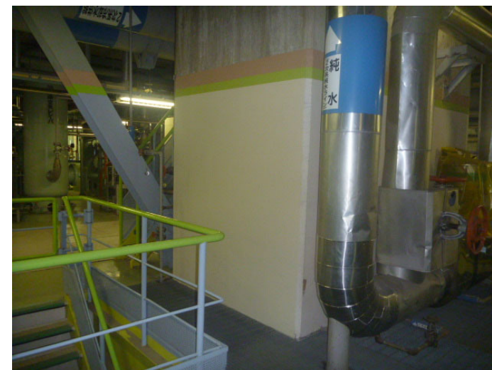
タービン架台
