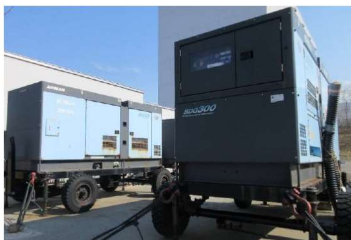
図4-11 緊急時対策所用発電機 外観
