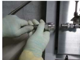
アニュラス全量排気弁等操作用可搬型窒素ガスボンベのカプラ接続 (周辺補機棟 T.P. 40.3m)
