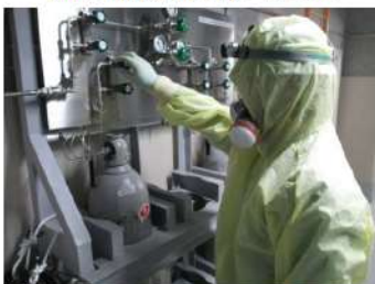
窒素供給操作(バルブパネル操作) (周辺補機棟 T.P. 40.3m)
