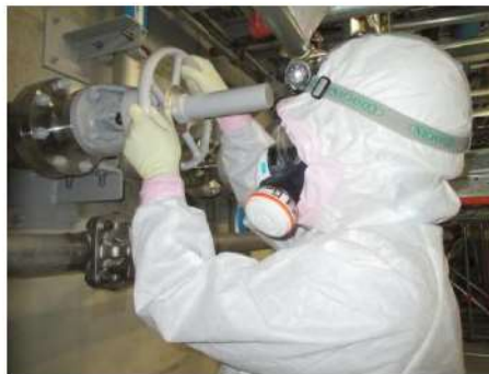
海から補助給水ピットへの補給 系統構成 (周辺補機棟 T.P. 17.8m)
