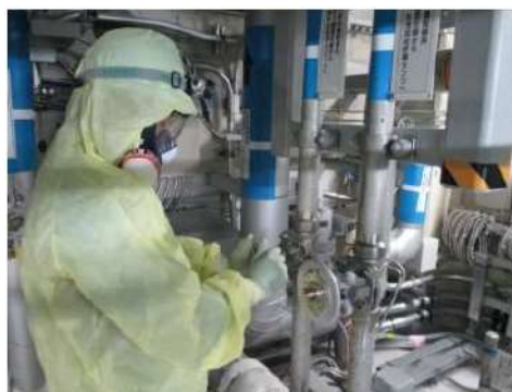
燃料取替用水ピット 補給ライン系統構成 (原子炉補助建屋 T. P. 10. 3m (中間床))
