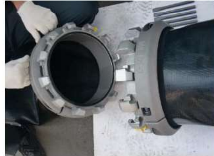
可搬型ホース(300A)接続
