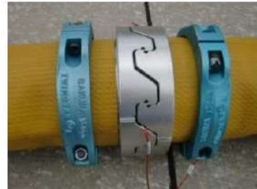
可搬型ホース (150A) 接続後
