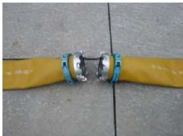
可搬型ホース (150A) 接続前
