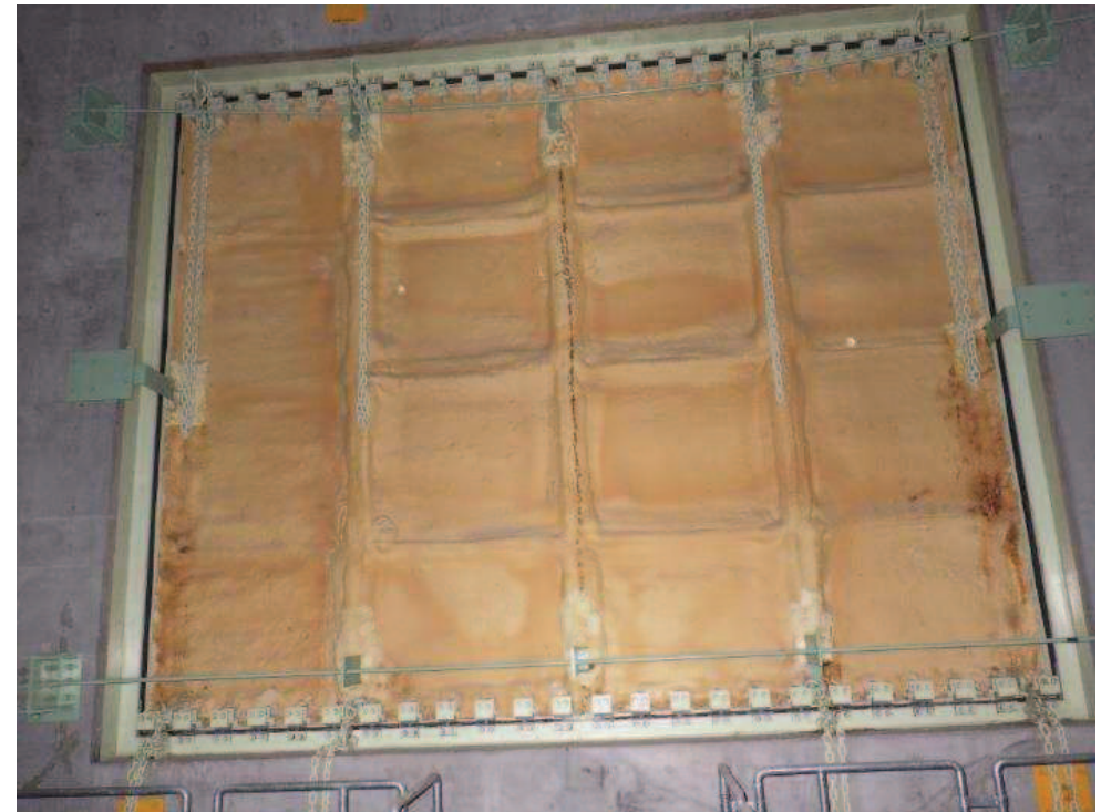
原子炉建屋ブローアウトパネル(内面)
