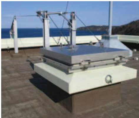
原子炉建屋ベント装置（閉止状態）
