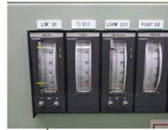
④温度指示計(制御盤)
