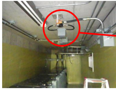
水素濃度検知器（蓄電池室の例）
