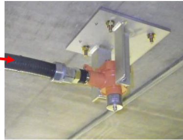
水素濃度検知器（拡大）
