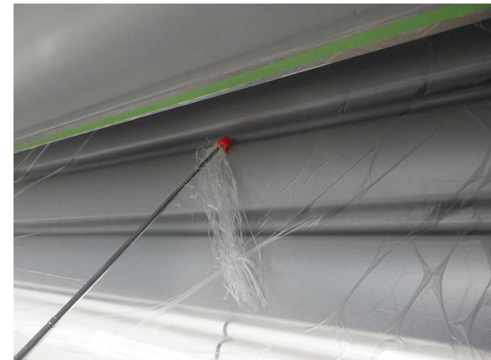
目張り実施中
