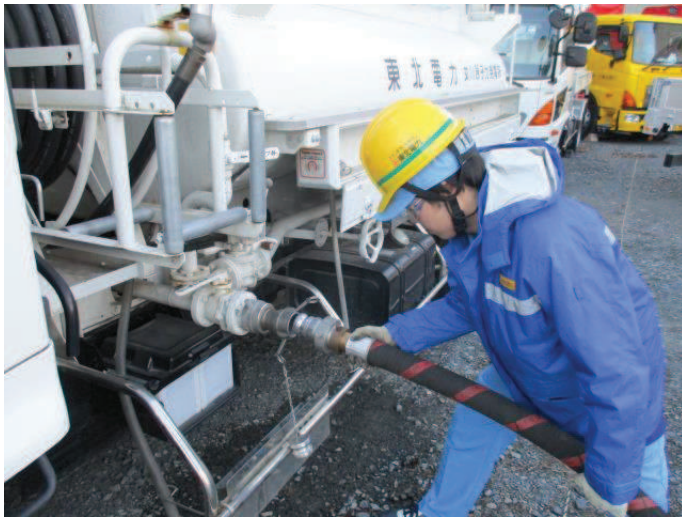
タンクローリへのホース接続
