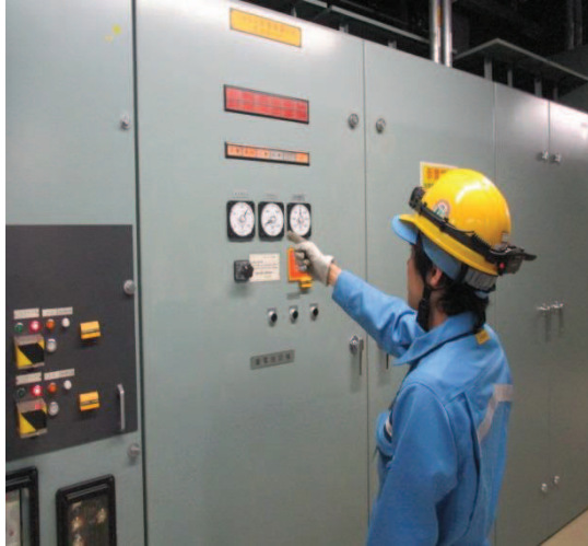
125V 代替充電器の受電状態確認
