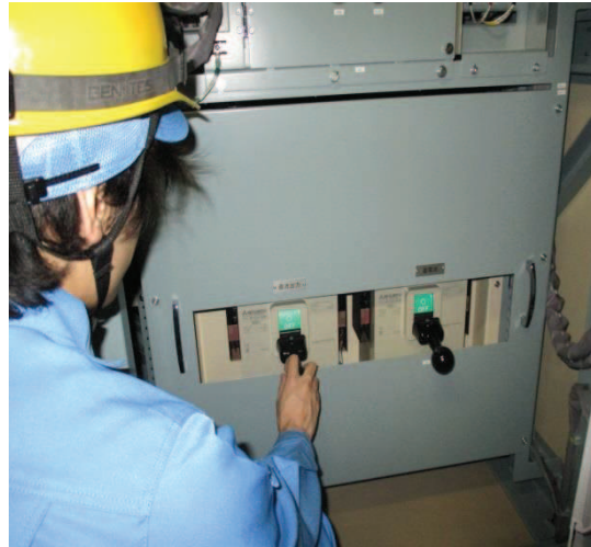
125V 代替蓄電池の切操作
