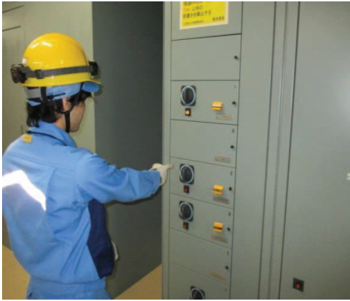
MCC 負荷の切離し操作
