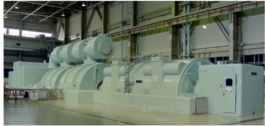
タービン発電機 (タービン建物 3階)
