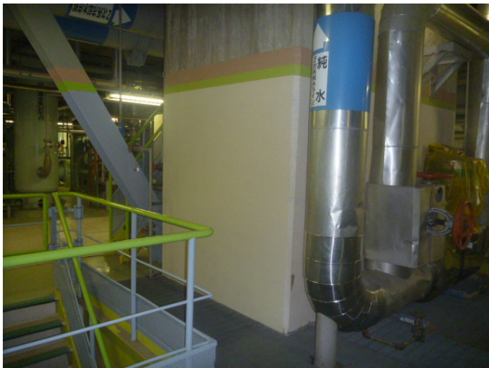
タービン架台
