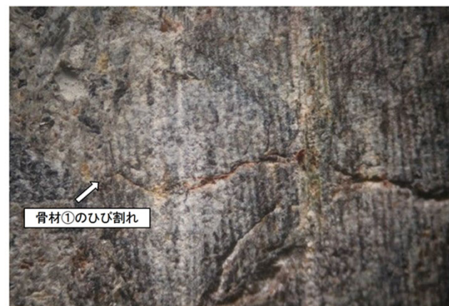
アルカリ骨材反応の点検状況(実体顕微鏡観察状況) タービン建屋 内壁及び床
