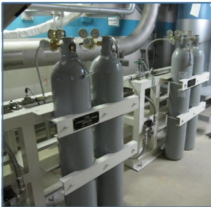
3号炉余熱除去ポンプ入口弁 駆動用窒素ボンベ
