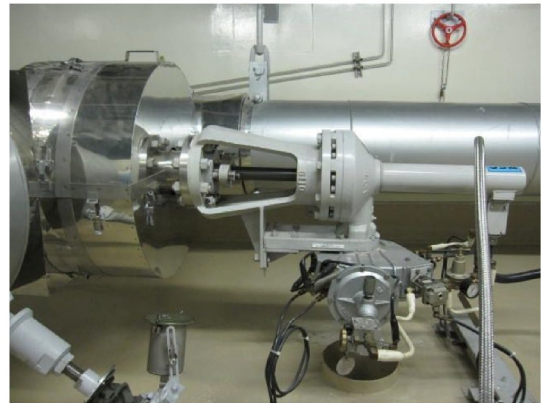
3 A 余熱除去ポンプ入口弁 (3V-RH-005A)
