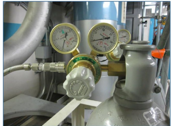
3号炉余熱除去ポンプ入口弁 窒素供給圧力調整弁
